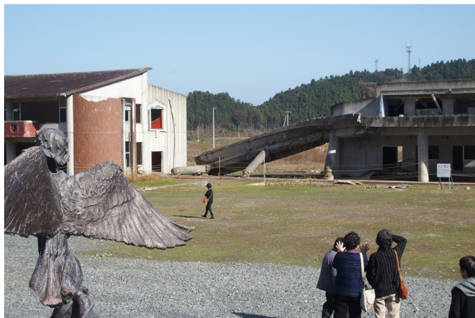
2階の渡り廊下の崩落
